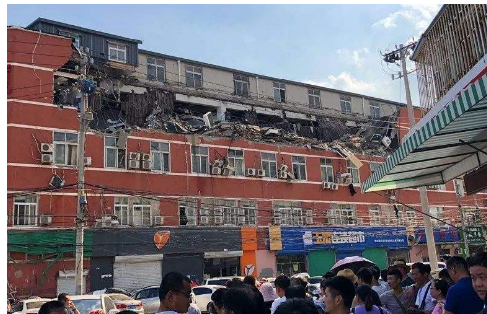
北京市丰台区顺和大厦 加层违建导致顶层大面积坍塌
