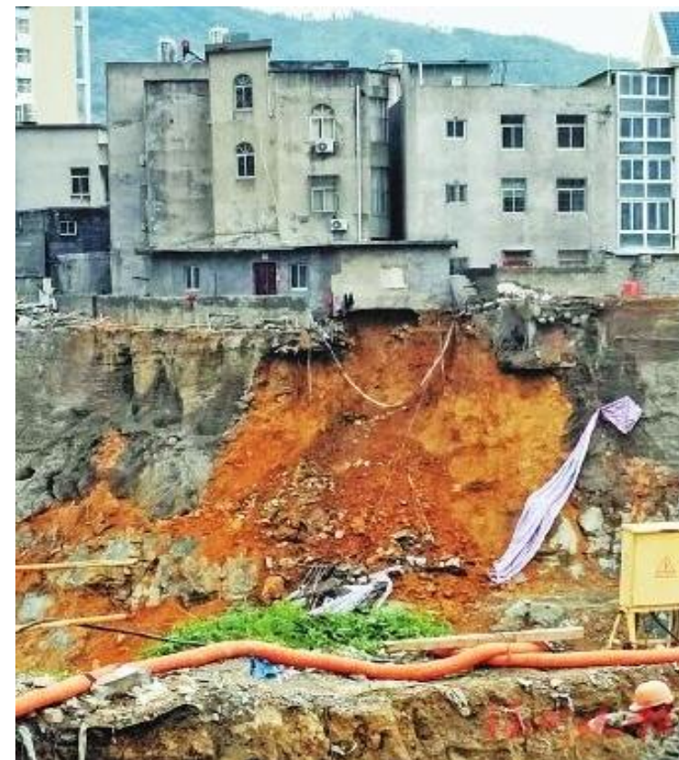
某工地基坑边坡塌方 导致住宅楼地基被掏空成为危房
