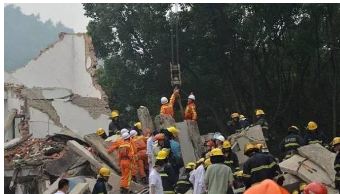
苏州老旧办公楼倒塌
