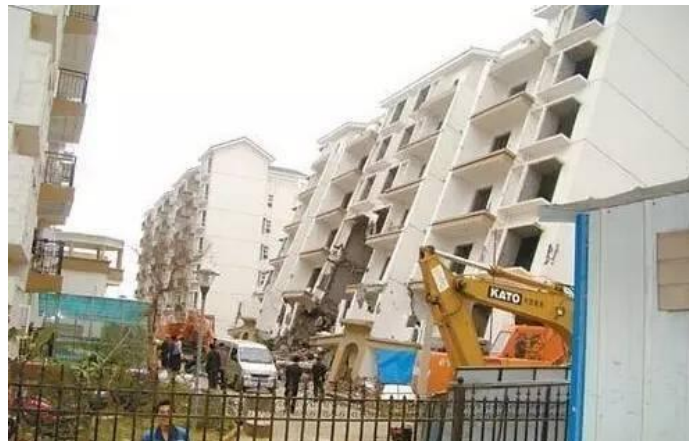
石家庄民宅倒塌
