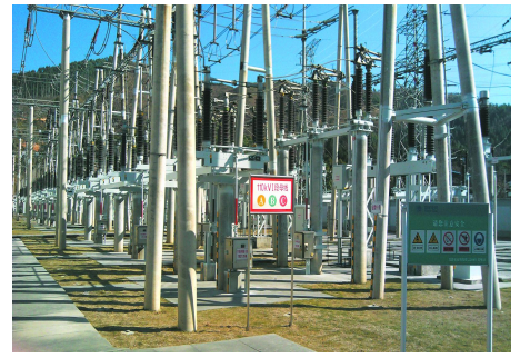
福州先锋 220 千伏变电站
